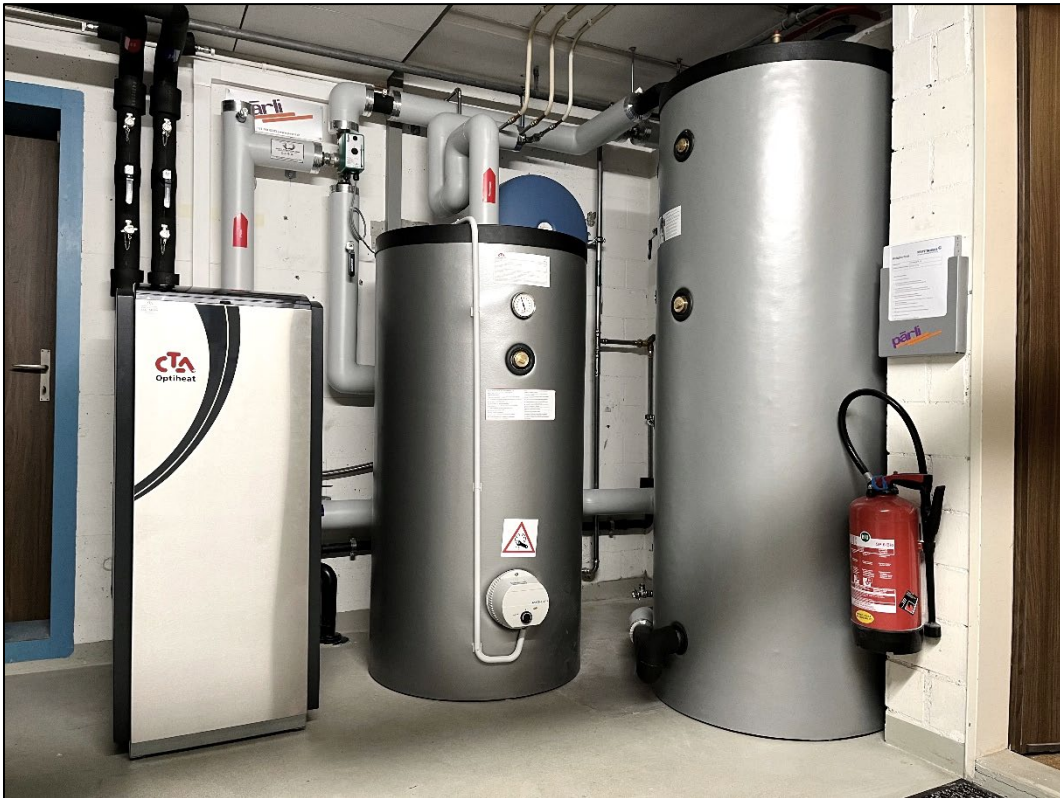
Erdsonden-Wärmepumpe mit Warmwasser- und Heizungsspeicher
