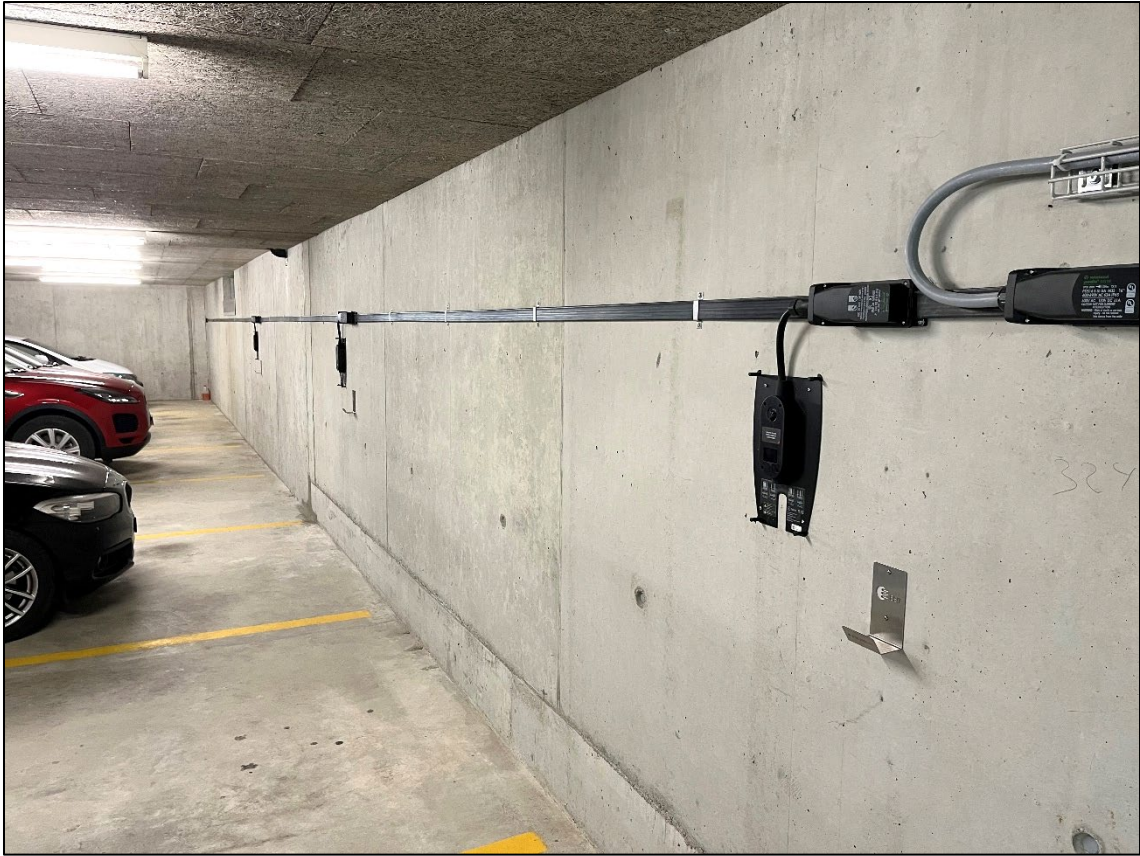
Erschliessung e-Mobilität in der Einstellhalle mit Flachbandkabel und Grundplatten
