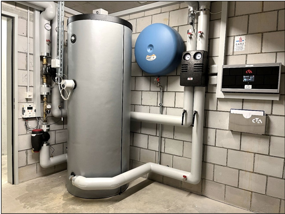
Inneninstallation der Wärmepumpe mit Puffer, Regelung, Wärmemessung
