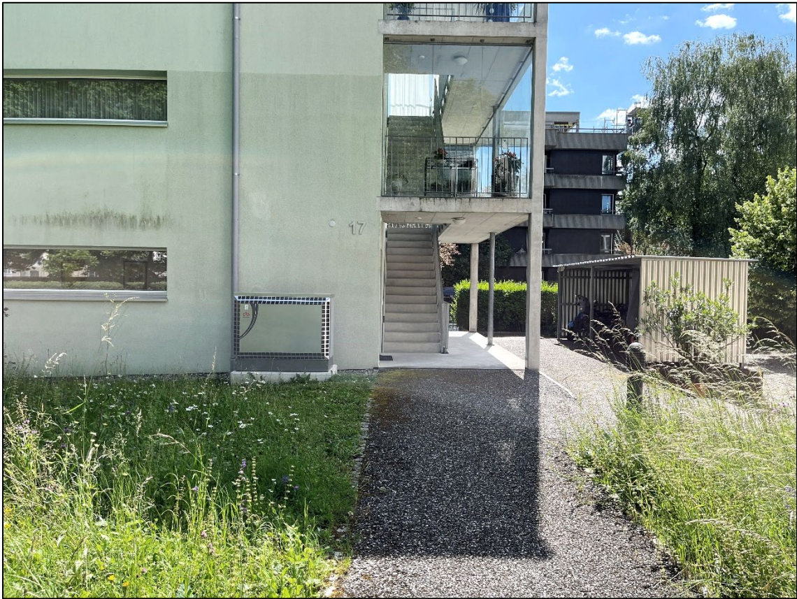
Luft-Wasser-Wärmepumpe an optimalem Aufstellort im Aussenbereich
