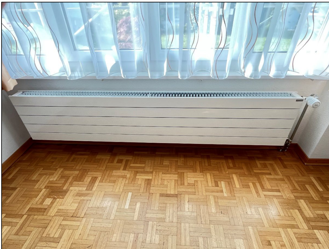
Die neuen Heizkörper mit hoher Abgabeoberfläche und grosser Wärmeleistung für niedrige Vorlauftemperaturen
