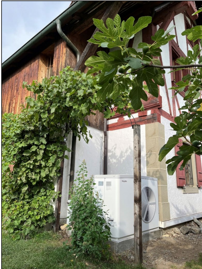
Luft-Wasser-Wärmepumpe auf der Gebäude-Rückseite
