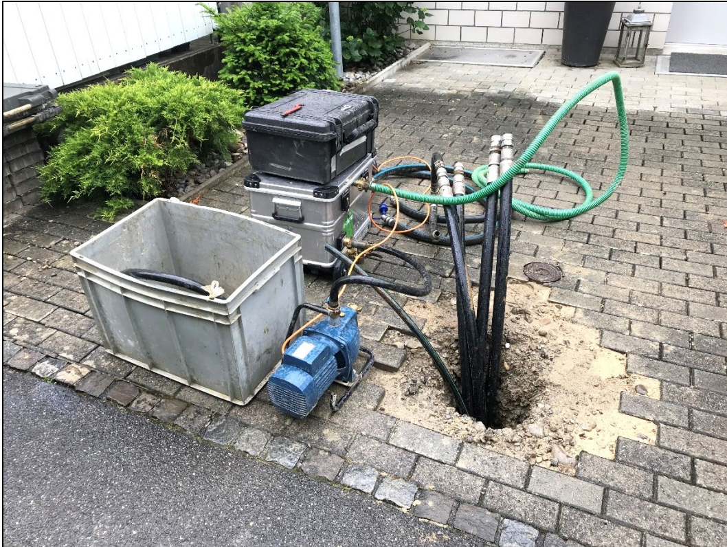
Dichtheitsprüfung der Erdsonde mit Protokollierung. Nach der Gebäudeeinführung ist auf dem Platz keine Installation mehr sichtbar.
