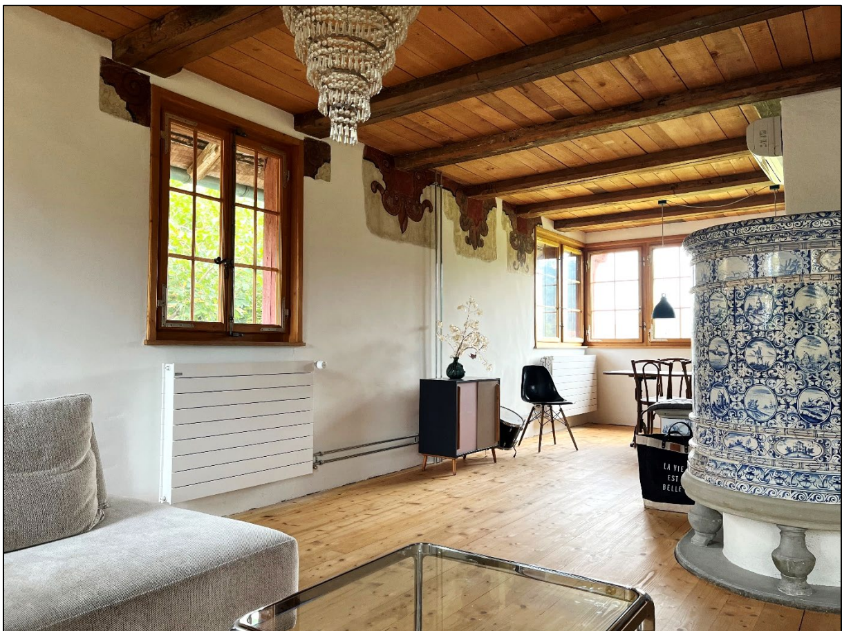
Erschliessung der Radiatoren im Wohnbereich
