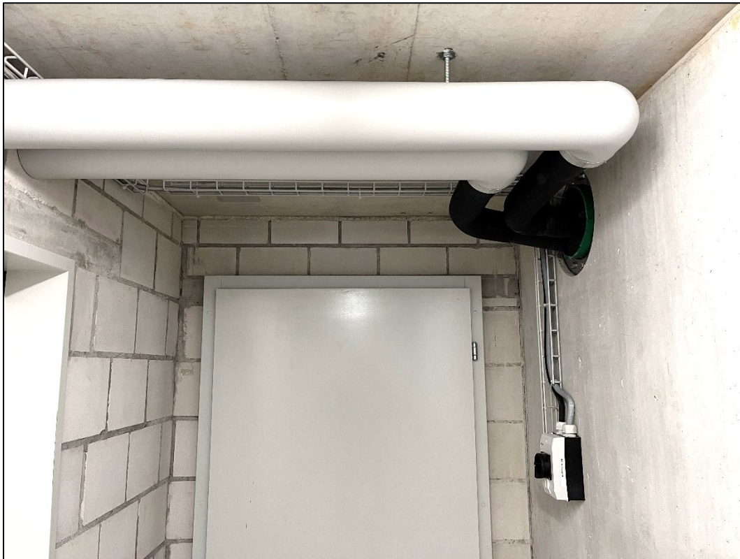
Gebäudeeintritt mit Erschliessung der Wärmepumpe
