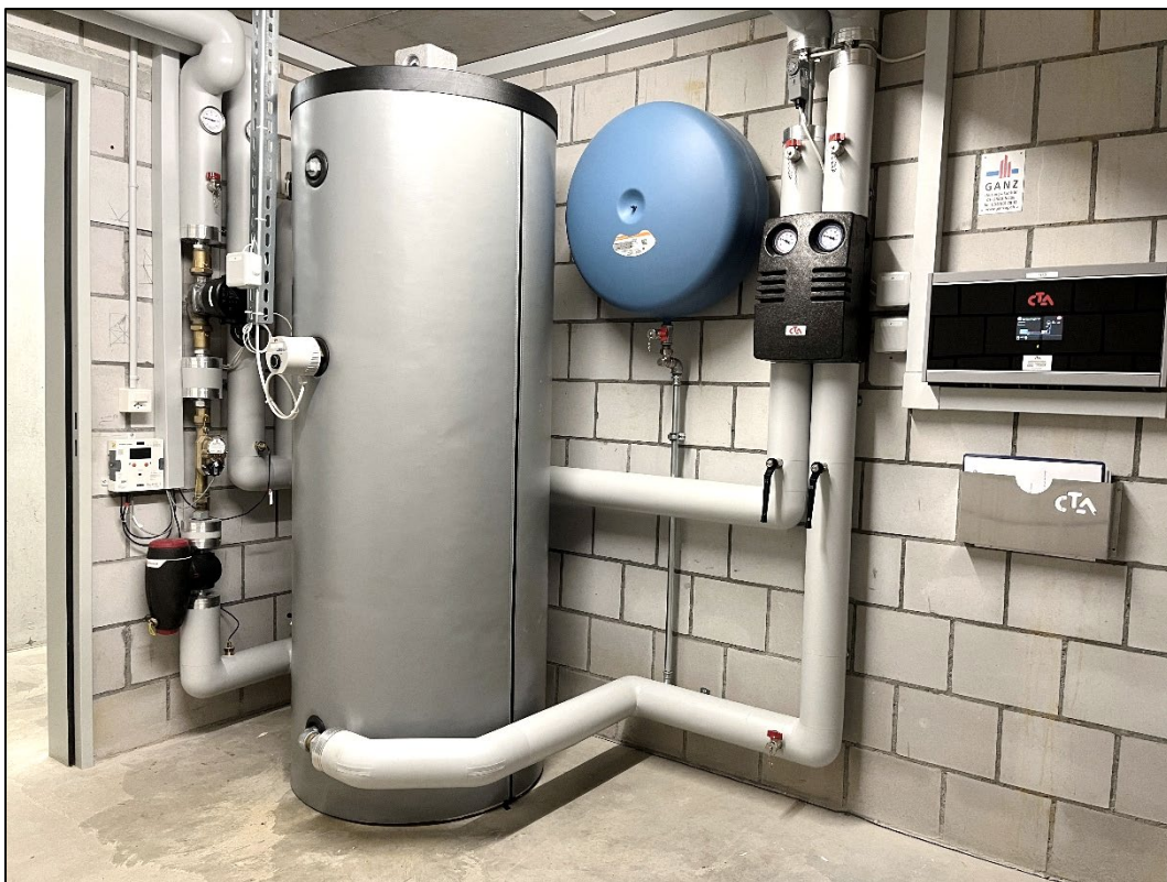
Wärmemessung, Pufferspeicher, Wärmeverteilung, Regelgerät mit Fernzugriff (Partnerfirma: Ganz AG)
