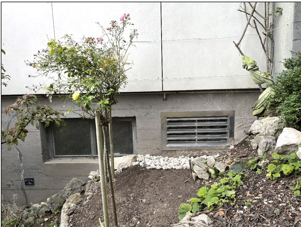
Für die Zuluft- und Fortluft der Wärmepumpe konnten das bestehende Heizungsfenster und der ehemalige Schacht für die Ölanlieferung verwendet werden
