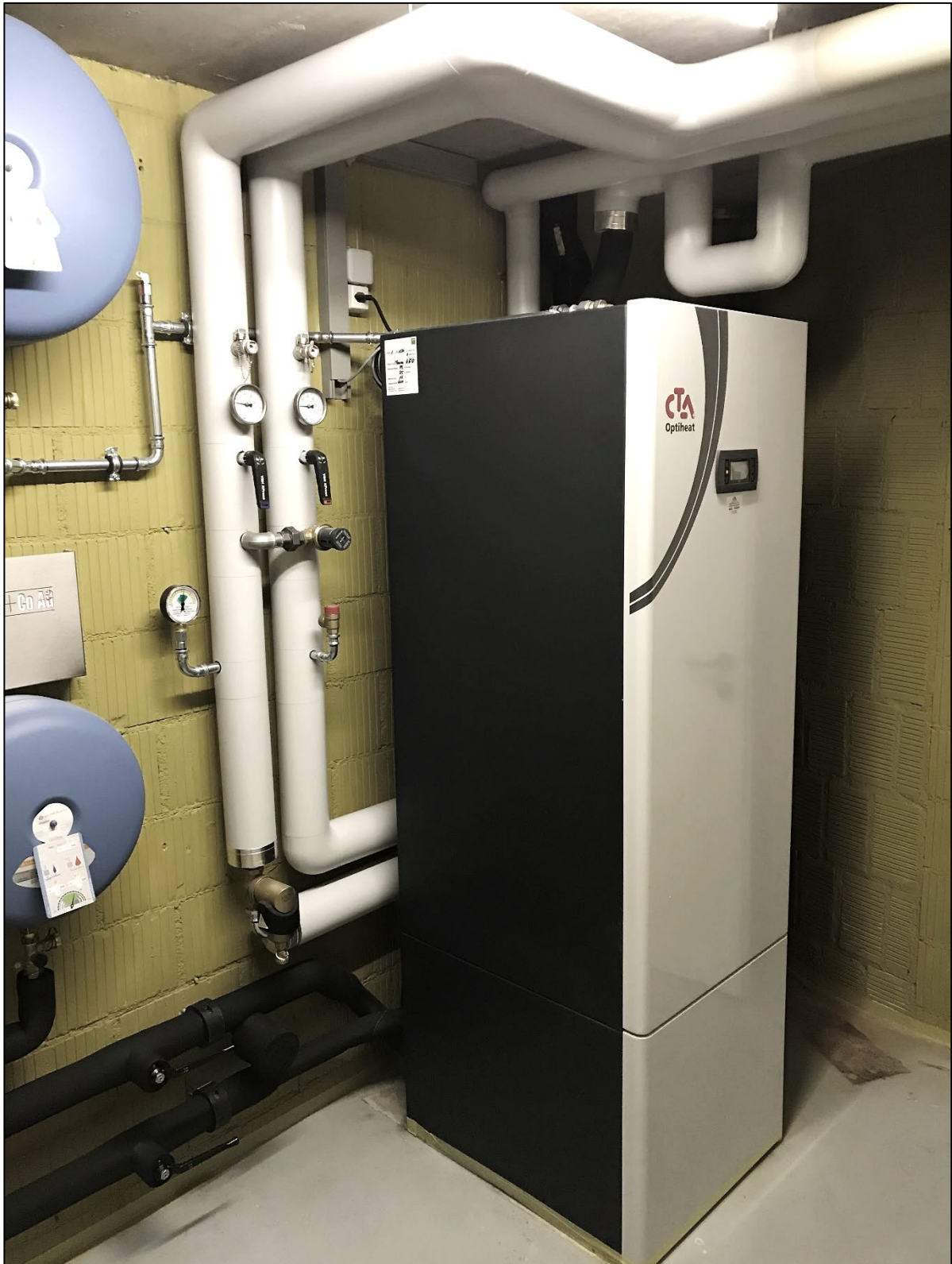
Erdwärme-Wärmepumpe Kombigerät für Heizen mit Warmwasser in einem Gerät (Partnerfirma: Badertscher + Co AG)
