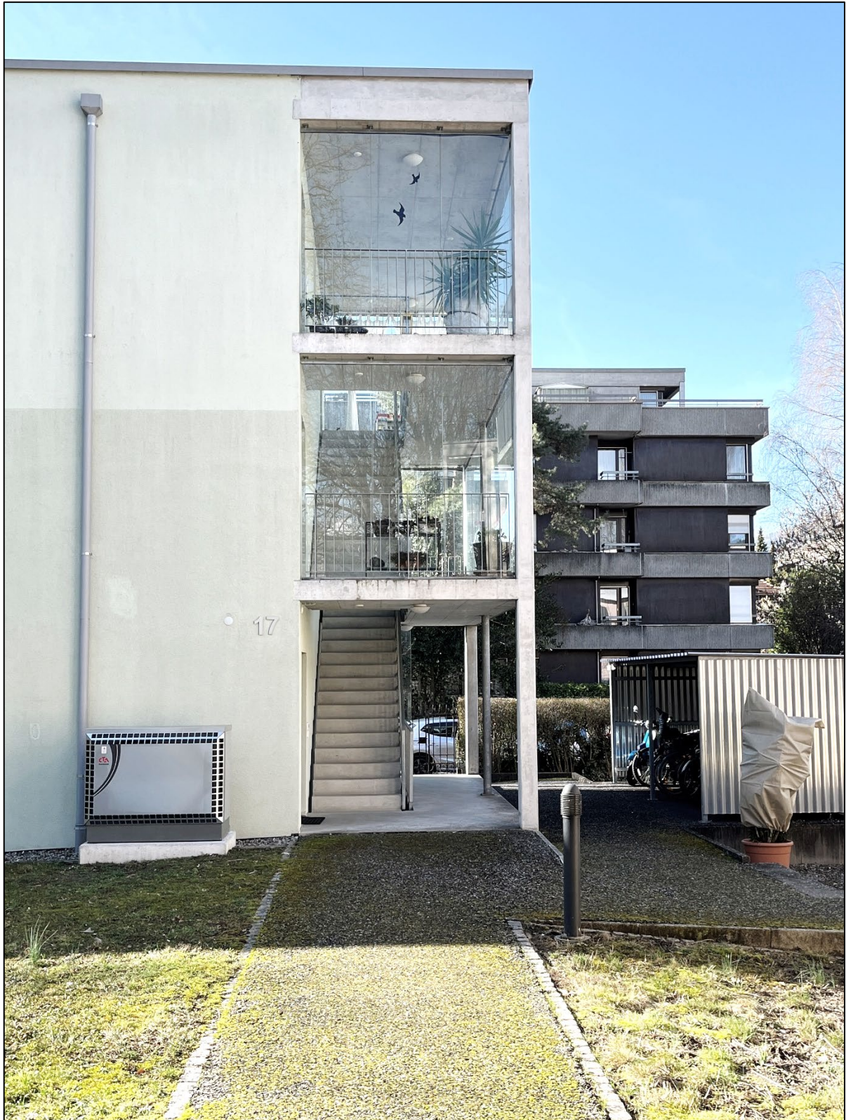
Luft-Wasser-Wärmepumpe an neutralem Aufstellstandort
