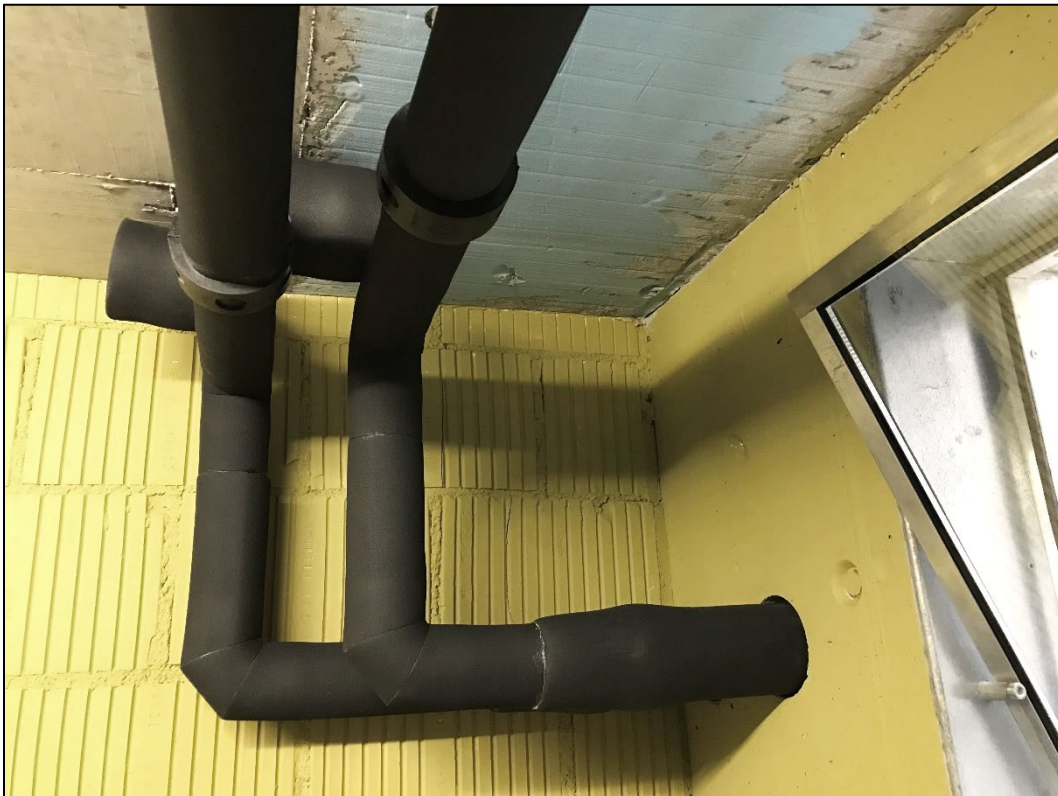
Gebäudeeinführung der Erdsonde mit luftdicht geschlossener Dämmung
