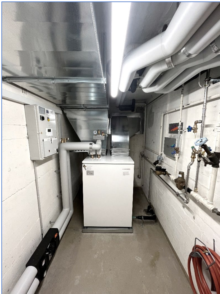
Innen angeordnete Luft-Wasser-Wärmepumpe (Partnerfirma: Pärli AG)
