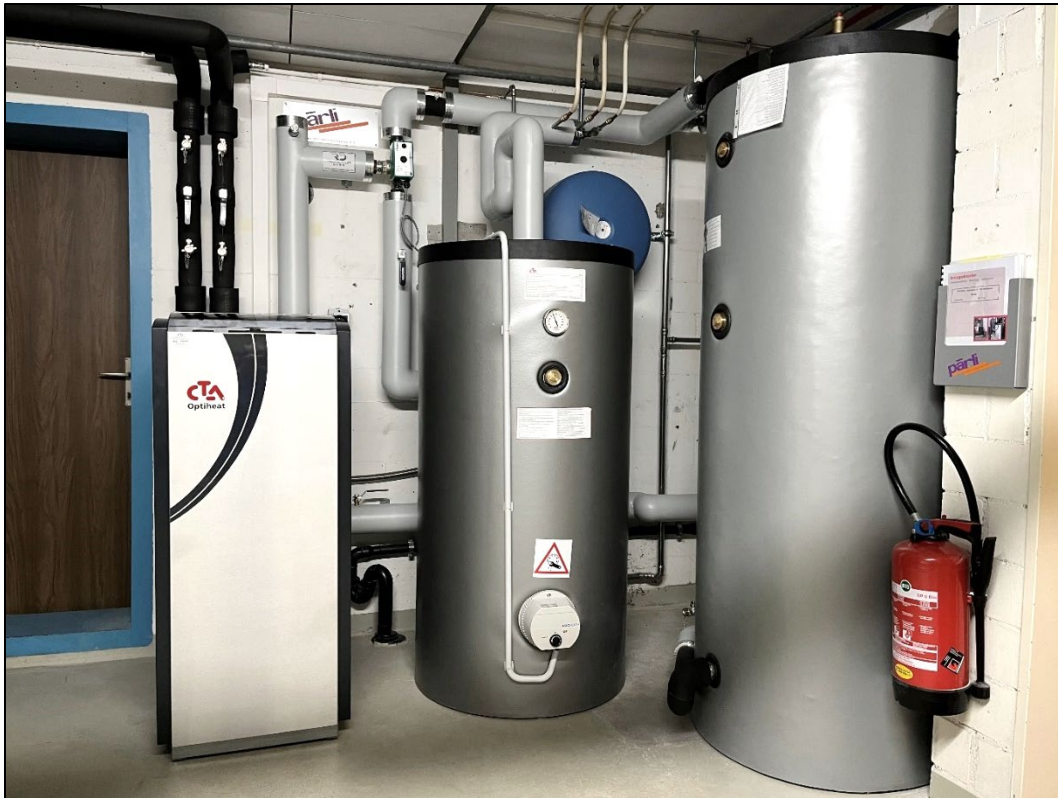
Erdwärme-Wärmepumpe mit Warmwasserspeicher und Puffer (Partnerfirma: Pärli AG)
