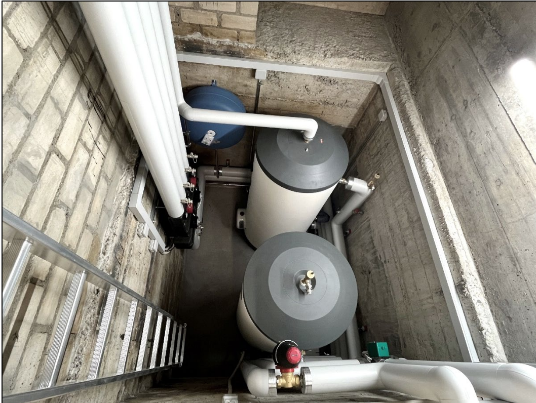
Warmwasserspeicher, Pufferspeicher und Heizkreispumpen sind im ehemaligen Tankraum aufgebaut
